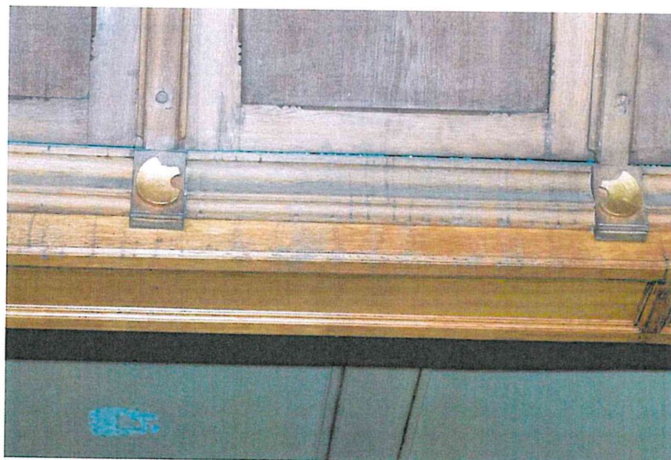
Fot. 20 Ślady po infiltracji wody na suficie.
